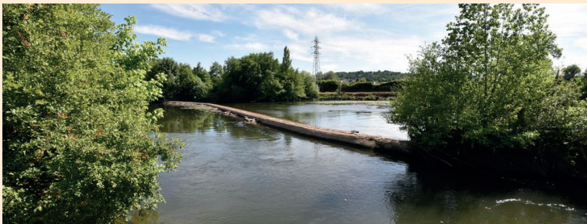
L'eau ne passe plus sur la chaussée crédit photo Nancy Ladde
