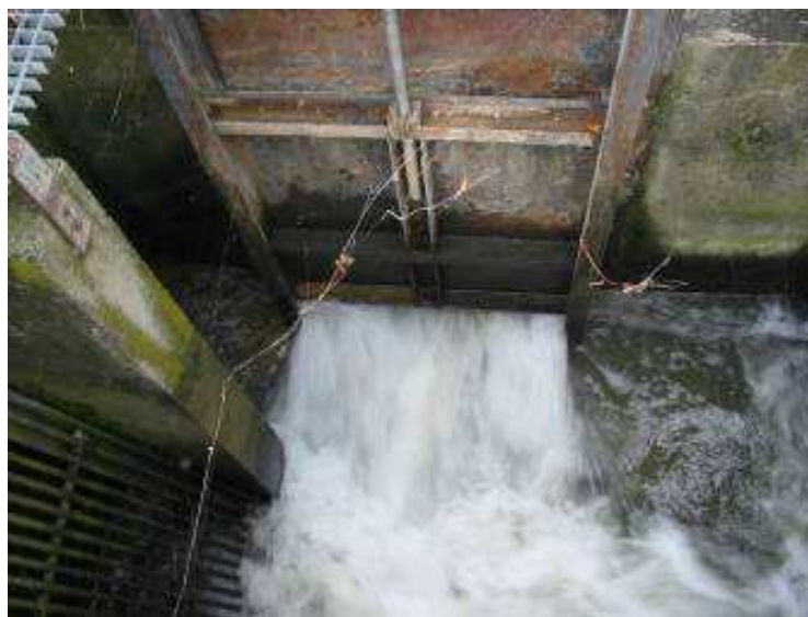
Figure 14 : Exemple d'écoulement sous une vanne de fond
